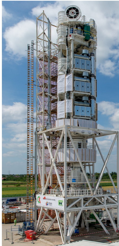
Abbildung 5: SBR im Aufbau vor der Abnahme
