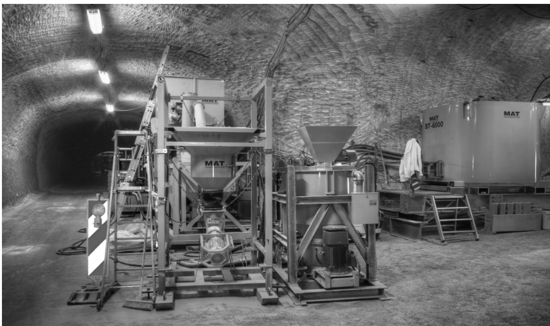
Abbildung 5: Kombinierte Dosier-, Misch- und Pumpanlage der Fa. MAT Mischanlagen-technik GmbH beim Einsatz auf der 820-m-Sohle des Bergwerks Gorleben
