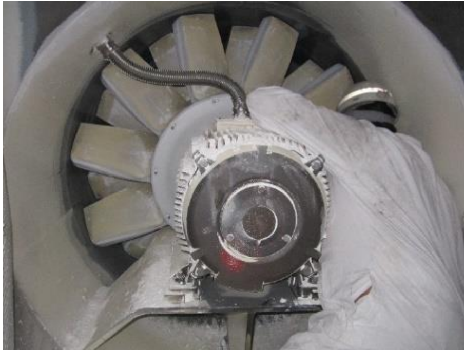
Abbildung 10: Lüfter unter Salzbedingungen
