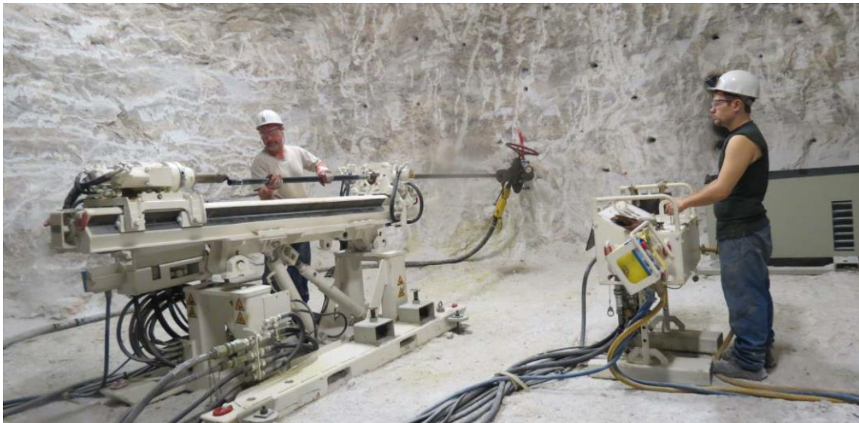
Abbildung 4: HLH 120 auf Transportrahmen bei der Erstellung von Bohrungen zur Ableitung von Restsohle aus Versatzkammern
