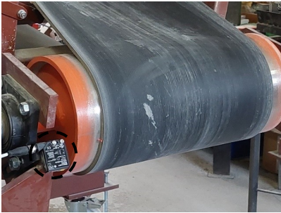
Lasersensor zur Messung der Gurtposition an der Antriebstrommel – strichlierter Kreis
